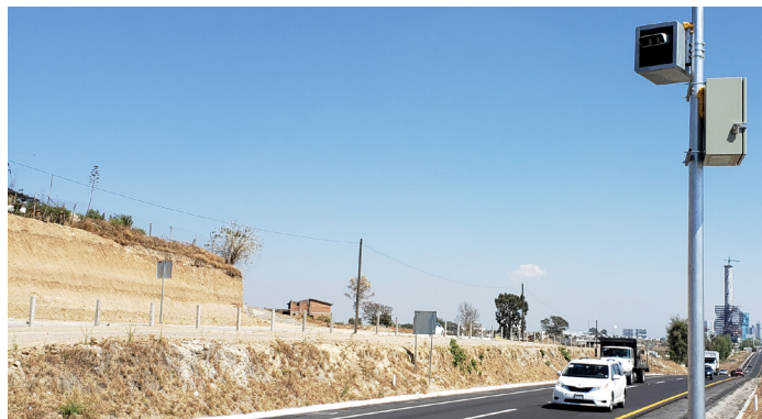
Une TrafficCam 3D surveille la vitesse près d'une route très fréquentée à Mexico
